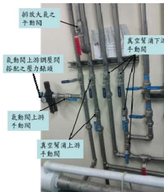
圖 3-2-3、管路下游與旁通槽、真空幫浦、緩衝槽之間的配管
