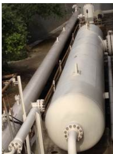
圖2-31、新設之15 m 3 高壓儲氣槽
