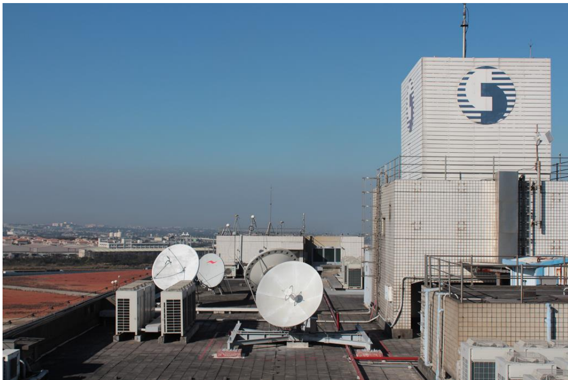
圖 2.2.3 本實驗室用來進行 TWSTFT 之衛星地面站室外設備
