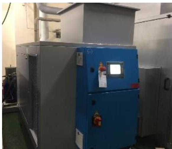
圖 5-4、高壓氣體壓縮機
